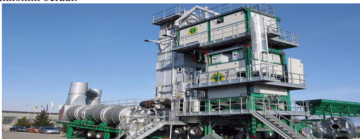
3.8-rasm. BERNARDI asfaltbeton qorishmalarini tayyorlash zavodi
