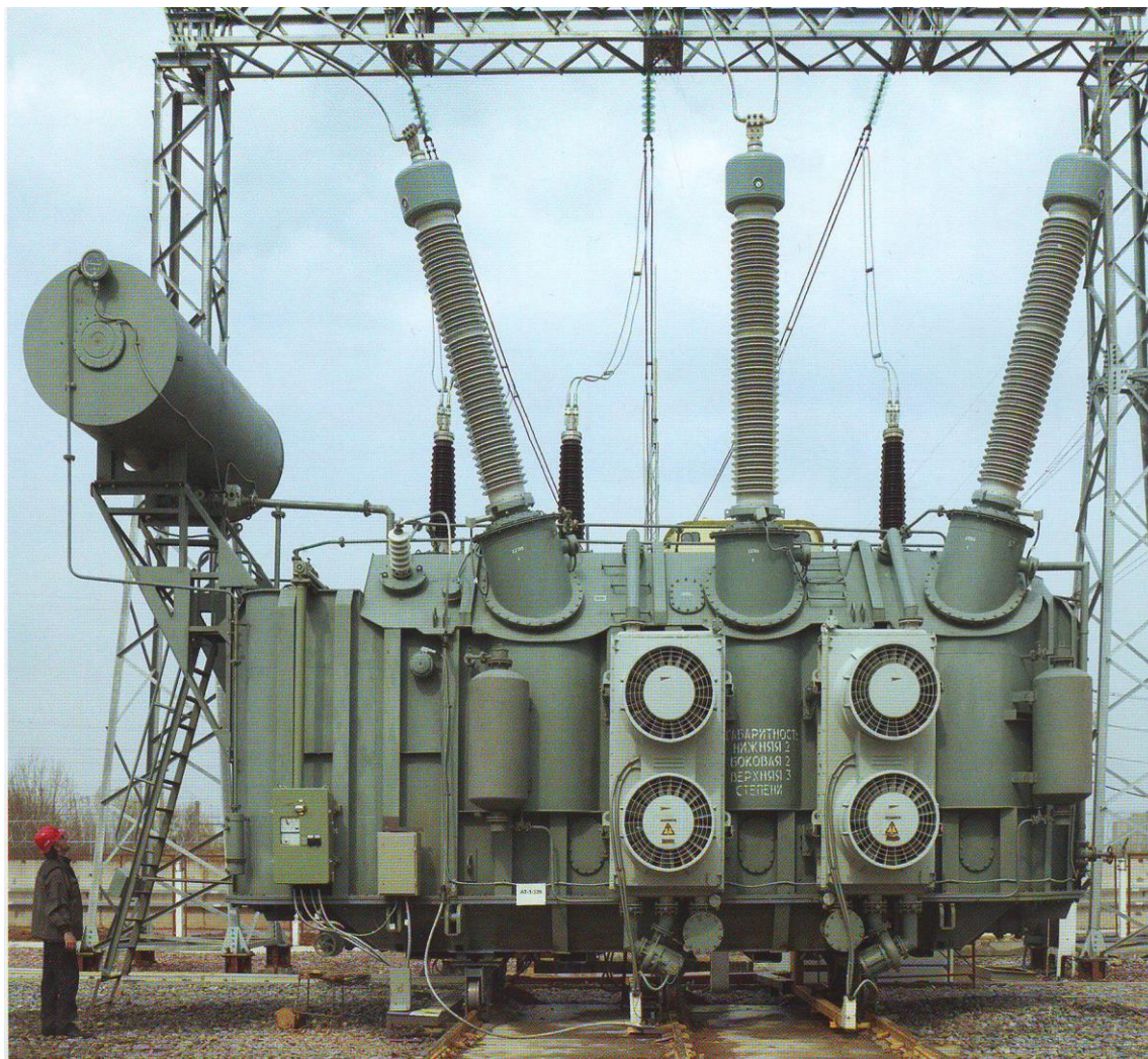
1.33-rasm. Elektr energetikasi sistemasida ekspluatatsiya uchun o'rnatilgan katta quvvatli yuqori kuchlanishli bir fazali uch chulg'amli avtotransformator
