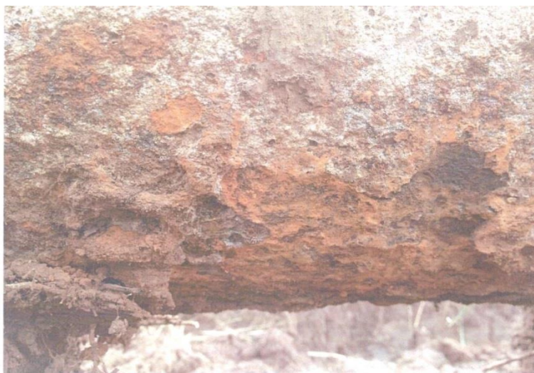
Рисунок 9 – Наружная коррозия трубопровода под землей на месте пересечения его с воздушной линией электропередач
