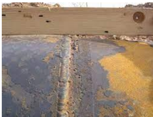
Рисунок 3– Общая коррозия на поверхности трубопровода на участке разрушенной изоляции
