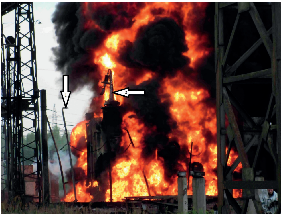
Рис. 1.1. Пожар на ПС 500 кВ «Арзамасская», 2010 год (1)
