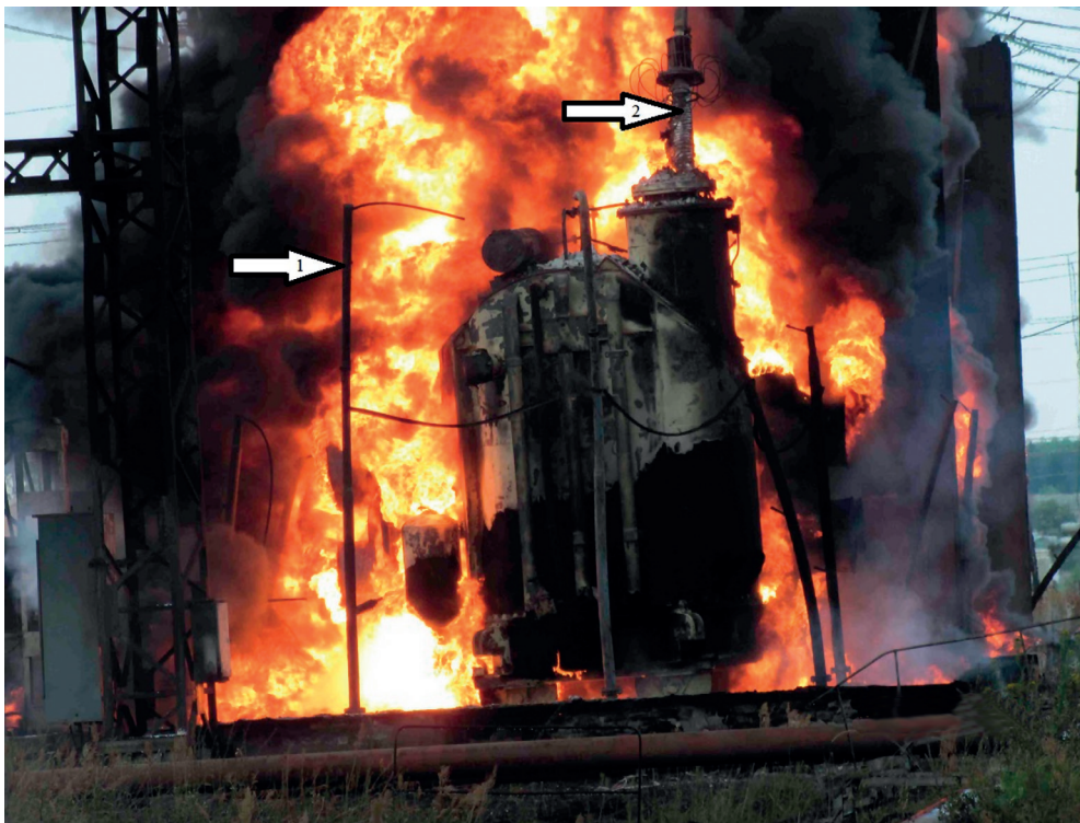
Рис. 1.2. Пожар на ПС 500 кВ «Арзамасская», 2010 год (2)
