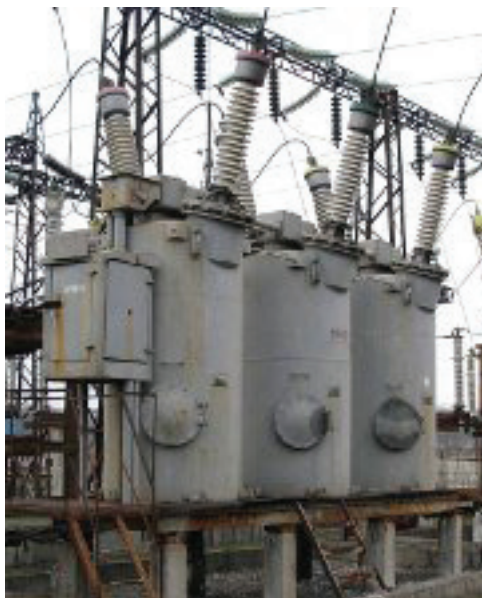
Рис. 7.1. Масляный выключатель повысительной трансформаторной подстанции
