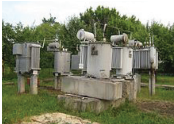
Рис. 7.3. Фото трансформаторов низкой мощности
