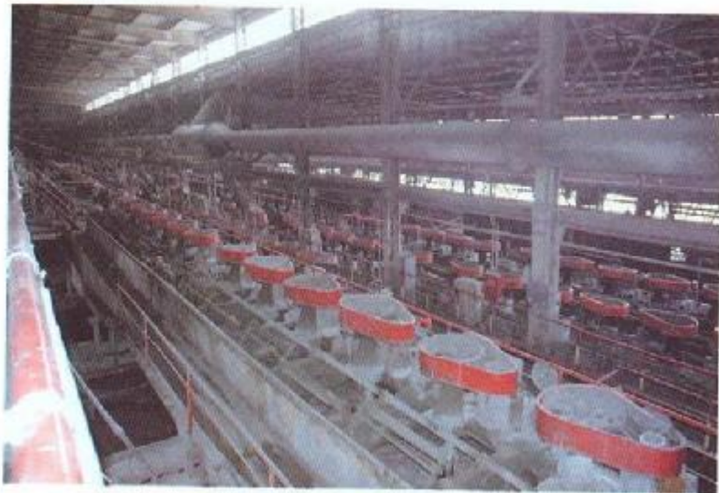
Общий вид цеха флотации, где производится переработка медных шлаков
