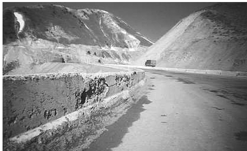
10.11-расм. Тузнинг бетон тўсиқларга таъсири (А-373 «Тошкент-Ўш» автомобиль йўлининг 158 км).
