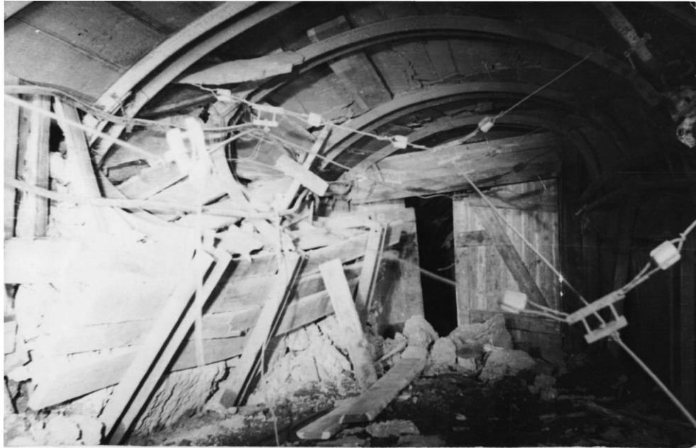
Рис. 5.2.8. Разрушение крепи из спецпрофиля в борту орта 18
