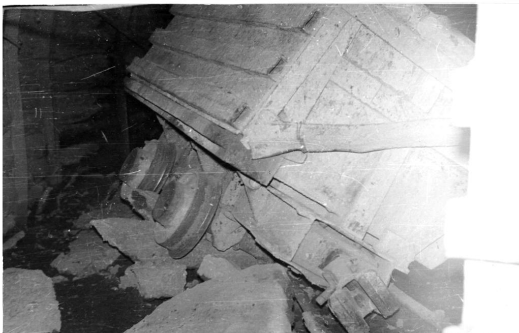
Рис. 5.2.6. Разрушение бетона в почве кольцевого штрека между ортами 16 и 17 горизонта –140 м
