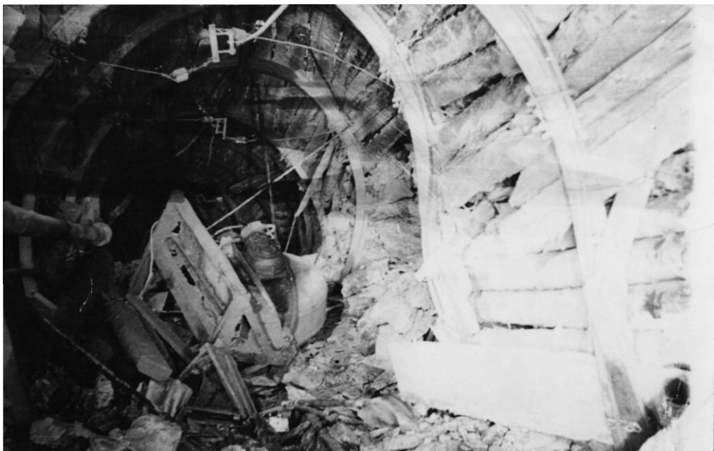
Рис. 5.2.13. Повреждение крепи и оборудования в орте 19
