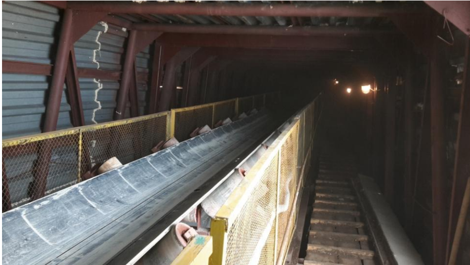
Рис. 2.4.11. Конвейер в наклонном стволе
