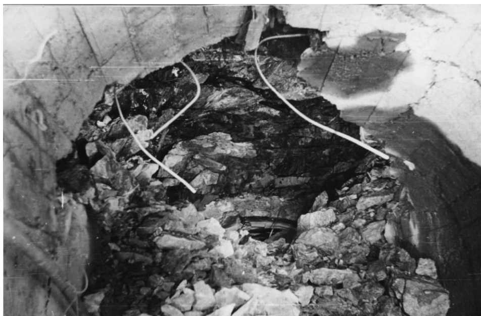
Рис. 5.2.10. Обрушение бетонной крепи в орте 18
