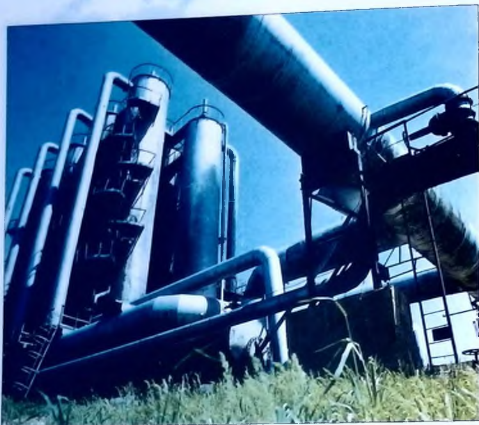
Скрубберы очистки газа
