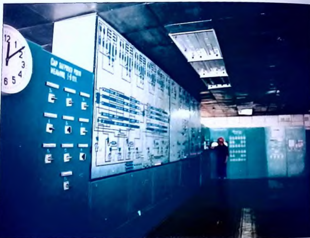
Медная обогатительная фабрика, центральный пульт управления
