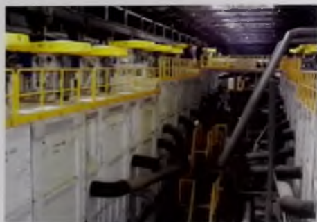
Рис. 1. VI–IX секции МОФ после реконструкции (флотомашини РИФ 45)
