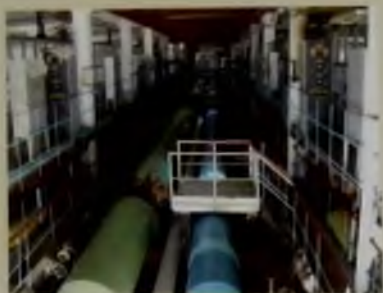
Рис. 2. Блок контактных осветлителей станции водоподготовки
