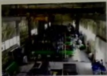
Рис. 1. Машинный зал насосной станции водозабора и подачи воды в г. Зарафшан
