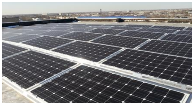
18.1-rasm. 20 kVt quvvatli quyosh fotoelektrik stansiyasining umumiy koʻrinishi
