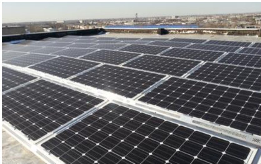
Рис 1. Обзор солнечной фотоэлектрической станции мощностью 20 кВт
