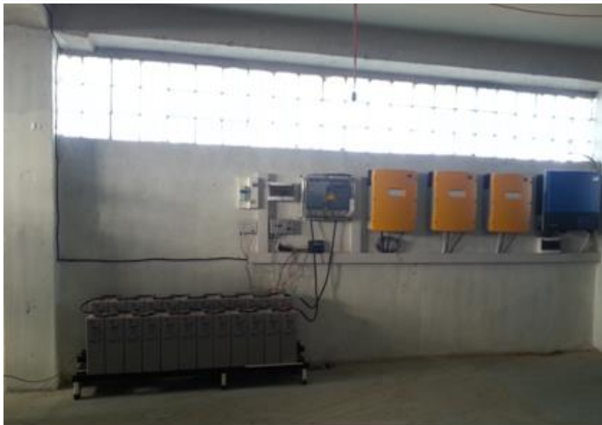
Рис 2. Блок управления энергией ФЭС 20 кВт и устройства управления
