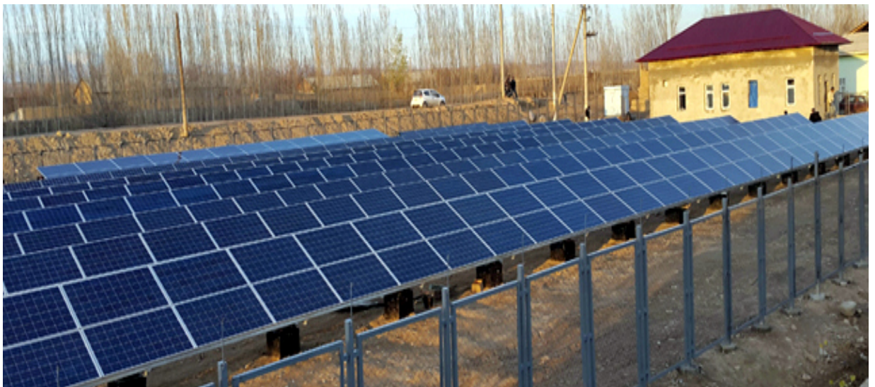
7.34- расм. Мамлакатимиздаги биринчи, қуввати 140 кВт бўлган куёш электр станцияси.
