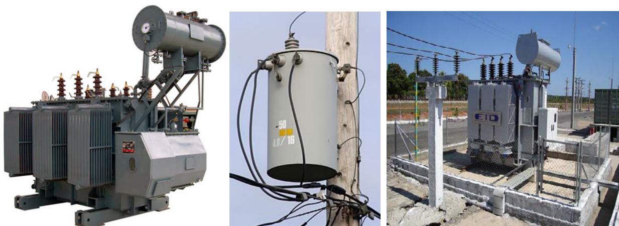
5.12-расм. Электр узатиш линияларининг мойли трансформаторлари.
