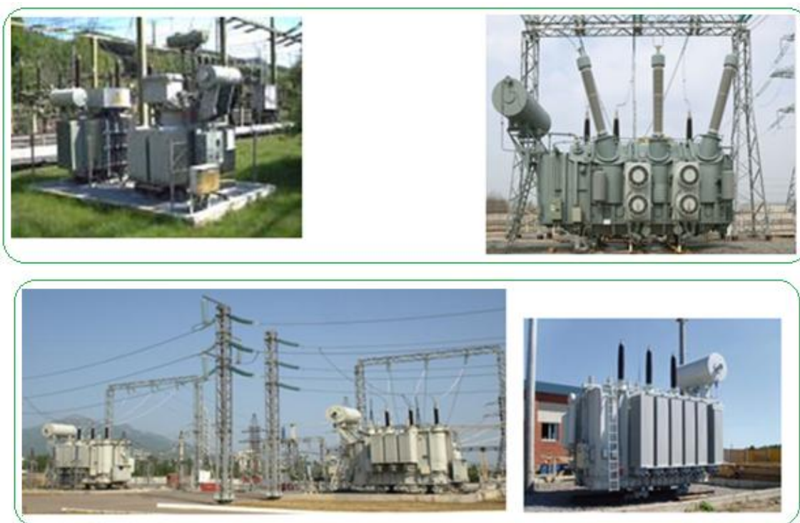
10.1-rasm. Elektr ta'minitida qo'llaniladigan kuch transformatorlari.
