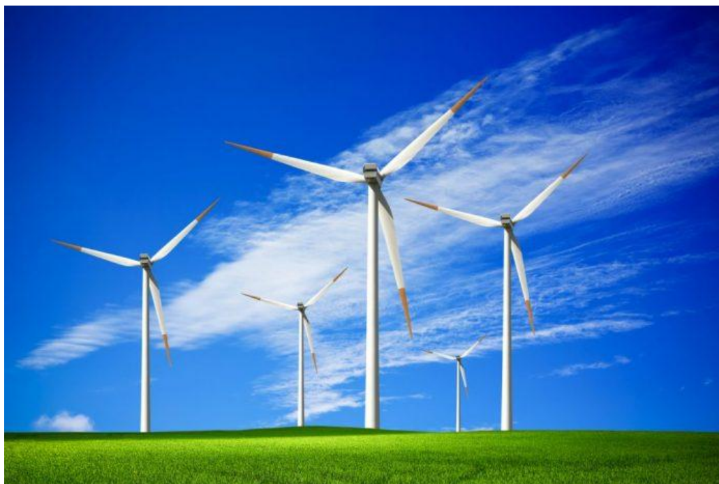
1.2 - rasm. Shamol elektrostansiyasining qir-adirlarda joylashuvi.
