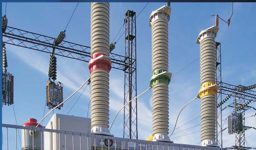
ВГТ-110 на подстанции г. Обнинск, Калужской области
