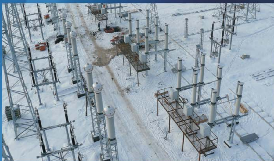
ВГТ-220 на подстанции "Пушино" г. Рязань
