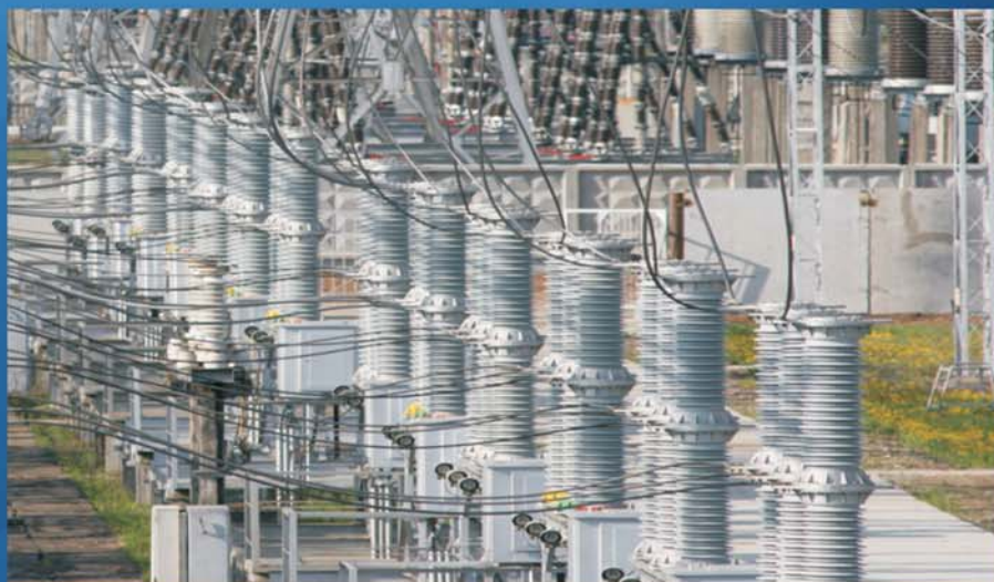
ВГТ-110 на Воткинской ГЭС, Пермский край
