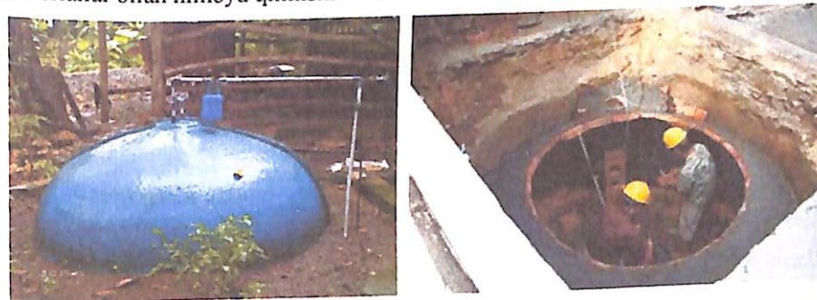
4.10-rasm. Fermentator rezervuari qisman yoki to'liq yer ostida joylashgan biogaz qurilmasi konstruksiyasi
