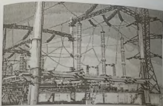
68-rasm. Izolatorlar shodasining ko'rinishi.
